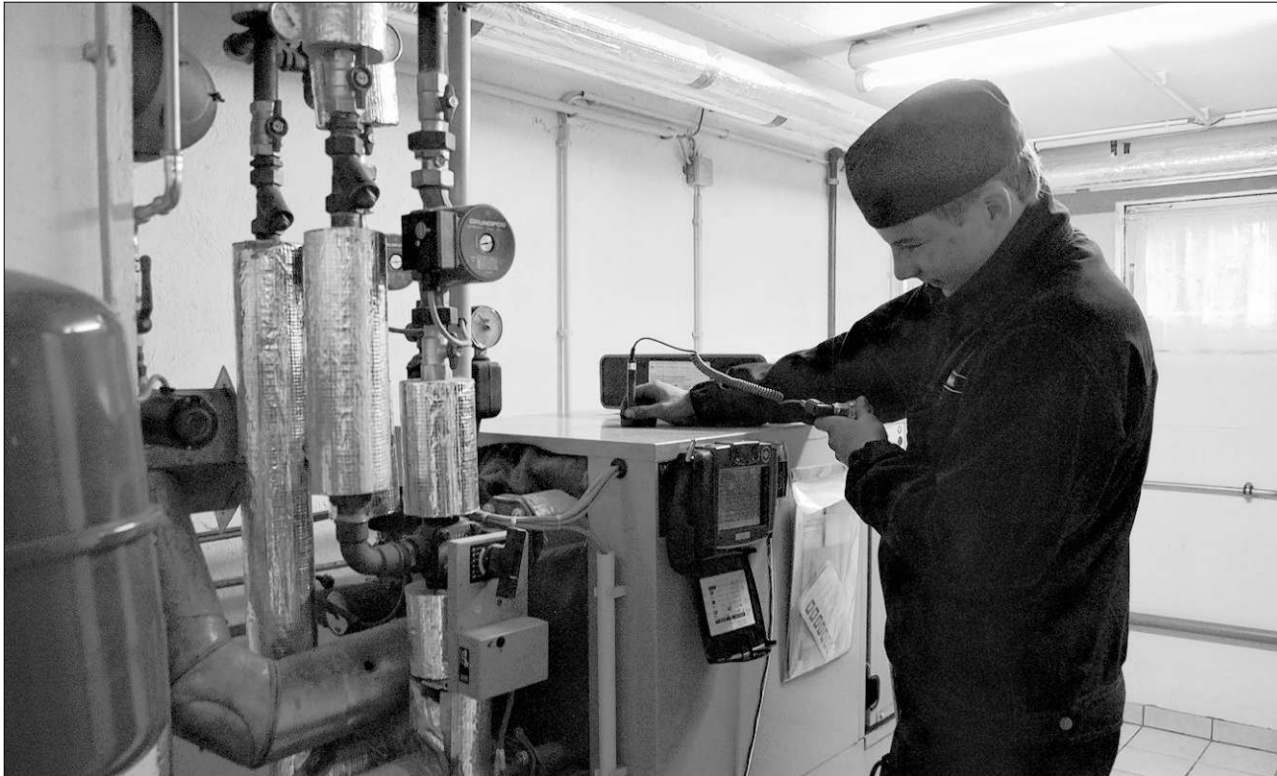
Beim Heizungcheck misst Michael Meindl die Oberflächentemperatur der Anlage.
